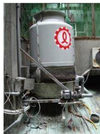
室外抽水馬達易漏電，檢電、斷電為優先。
